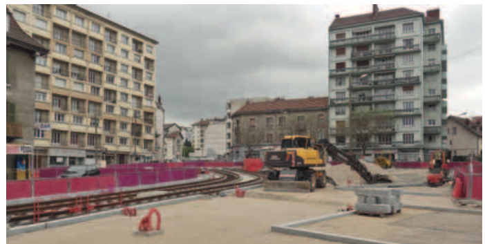
↑ LES REVÊTEMENTS DE L'AVENUE CARNOT SE POURSUIVENT ET SUR LA PLACE FLORE LES AMÉNAGEMENTS SE DESSINENT.
